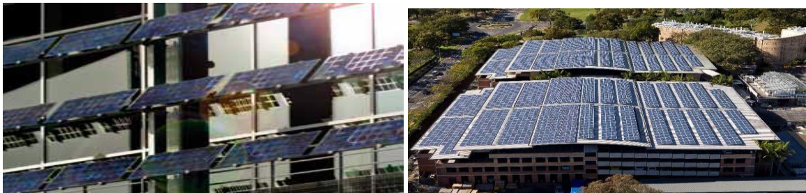
Figure 14: PV sur toit (Source (MDDE, 2011) ; Trina Solar 16 )
